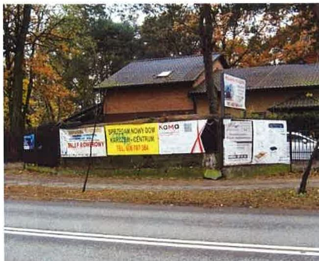
Fot. 43. Schron bojowy (4d) zastłony od ulicy ogrodzeniem i banerami, widoczny nad ogrodzeniem strop obniża się w lewo - ku ścianie czołowej. Widok z północnego wschodu.
