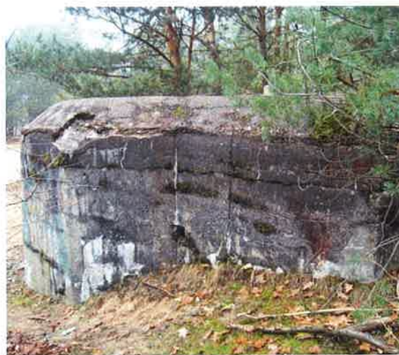
Fot. 28. Schron (3a) - widok od południa na prawą ścianę z aneksem mieszczącym zakończenie przedsiionka, na załamaniu wylot otworu instalacyjnego - przypuszczalnie na kabel telefoniczny.
