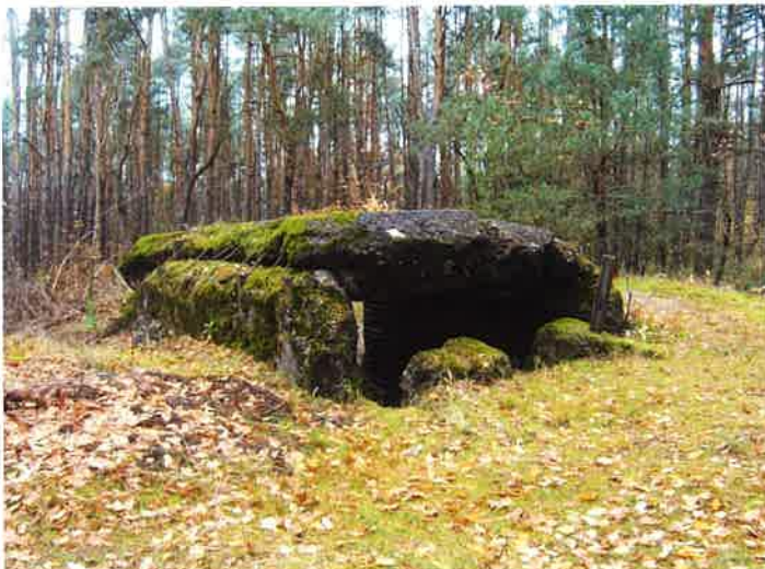
Fot. 8. Schron bojowy (1g) - widok z południa. Widoczne położenie schronu na szczycie lokalnego wzniesienia, odsłonięta po osunięciu się nasypu maskującego górną część prawej ściany i popękany od wybuchu strop. Ściana czołowa z oderwaną górną częścią odchyloną i wciśniętą w nasyp, z częściowo zasypianym, rozglifionym otworem strzelniczym ckm i szyną zbrojenia.
