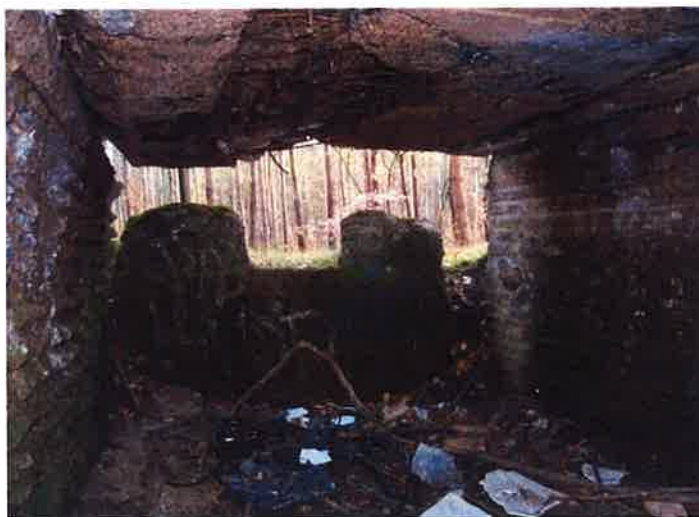
Fot. 11. Schron (1g) - widok na wnętrze izby bojowej od strony wejścia. Na wprost ściana czołowa ze strzelnicą ckm, na bocznych ścianach odcisk zerwanej blachy falistej, w popękany i wygięty stropie odsłonięte zbrojenie i ślady po dwóch zatopionych w betonie wzdłużnych listwach.
