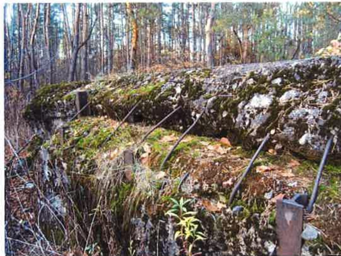
Fot. 9. Schron (1g) - pęknięcie i ubytki na styku prawej ściany i stropu, widoczne zbrojenie: pręty zewnętrznej siatki i górne końcówki wzmacniających ścianę pionowych szyn kolejowych, rozmieszczonych naprzemiennie w dwóch rzędach.
