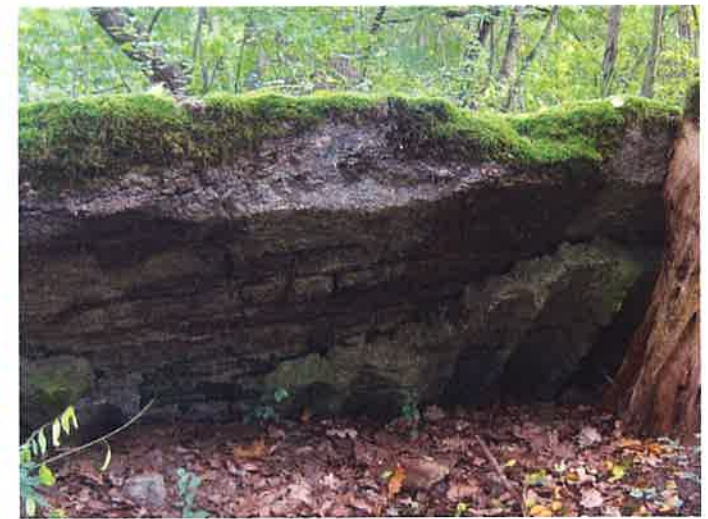
Fot. 4. Spodnia część płaszcza schronu (1d) - widoczne odciski belek, odspojenie warstwy wyrównawczej, odcisk i resztki siatki zbrojenia oraz drobnoziarnista struktura betonu.
