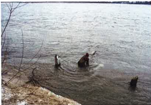
Fot. 48. Pozostałości mostu w Świdrach Mł. (5a) -ogłędziny odsłoniętych przy prawym brzegu słupów i stalowej belki. Fot. S. Fuglewicz, 2012 r.
