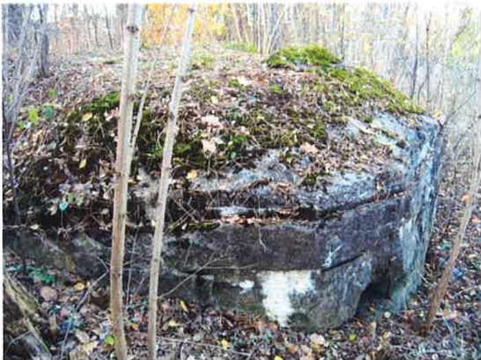
Fot. 31. Schron obserwacyjny (3b) - widok z południowego wschodu na ścianę czołową z częściowo zachowanym tynkiem maskującym i uszkodzeniem krawędzi szczeliny obserwacyjnej. Na stropie po prawej wzniesienie zaczopowanego otworu dla peryskopu.
