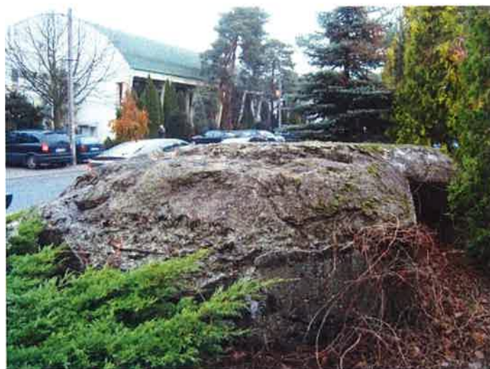
Fot. 21. Schron (2d) - widok z południa na przesłoniętą zielenią ścianę czołową i lewą z aneksem przedsionka. Widoczne duże uszkodzenia wierzchniej warstwy stropu i górnej partii ściany, na ścianie i zachowanych skosach nie ma rowków i śladów tynku.
