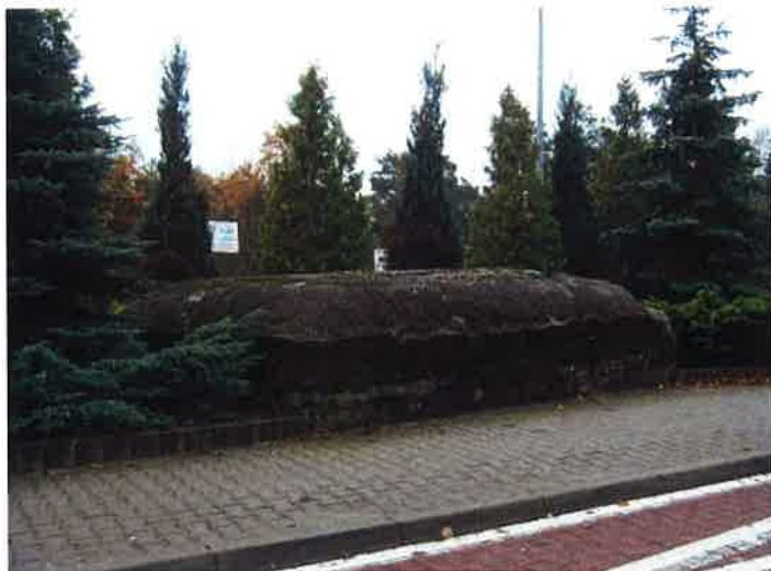
Fot. 20. Schron obserwacyjny (2d) - widok z północy na ścianę tylną (przesłoniętą zielenią) i prawą. Wierzchnia warstwa betonu nie została uszkodzona przez warunki atmosferyczne, ubytki pojawiły się na linii połączenia warstw i od uszkodzeń mechanicznych.
