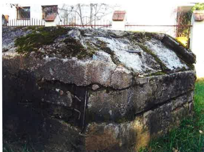
Fot. 17. Schron (2b) - naroże ściany prawej i czołowej. Widoczne fragmenty zewnętrznej siatki zbrojenia i stalowych kształtowników wzmacniających ścianę i strop, resztki tynku maskującego i poziome trapezowe rowki w ścianie czołowej oraz pozostałości pionowych rowków w zerodowanym skosie nad ścianą czołową.
